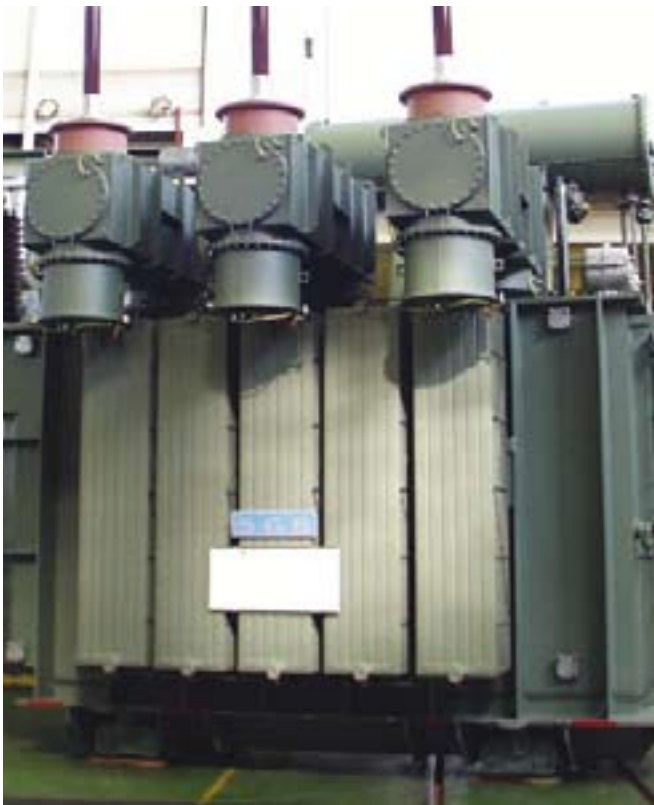
Bild 8: HV-CONNEX-Prüf- und Übergangsanschlusssteil, überspannungsseitig am Leistungstrafo (Trafo SGB Regensburg)
