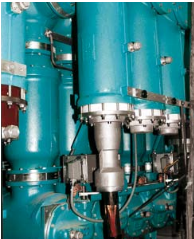
Bild 5: GIS Siemens Typ 8DNg mit Kabelanschlusssystem HV-CONNEX und IEC-Verlängerungsadapter
