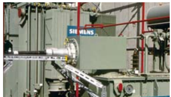
Bild 7: HV-CONNEX-Kabelverbindung: Trafo - E-Spule-Trafo Siemens-PCK Schwedt
