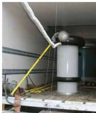
Zuverlässige Abnahmeprüfung vor Ort
