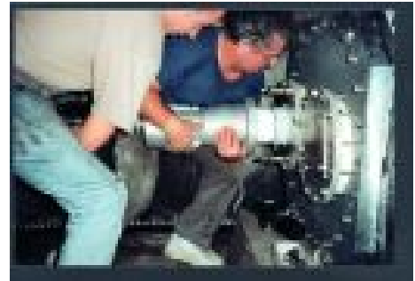
Montage von Hochspannungskabelanlagen
