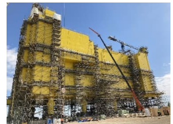
DoIWin kappa beim Bau im spanischen Cádiz. Die Konverterplattform verfügt erstmals über zwei GIS-Anlagen für Wechselstrom und Gleichstrom.
